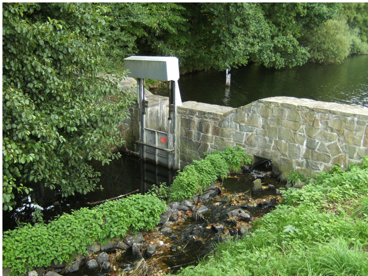
Foto 16: Stauanlage Kälberweide (Foto: Netteverband)
